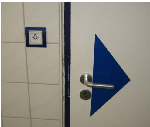
Bild 9 Kennzeichnung von Türdrückern durch einen kontrastreichen Aufkleber (Quelle: ift Rosenheim)
