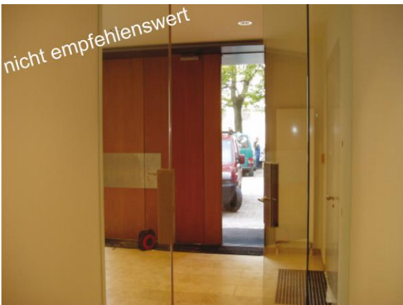
Bild 10 Schwer erkennbare Glastüren (Tür im Windfang eines Mehrfamilienhauses) (Quelle: ift Rosenheim)
