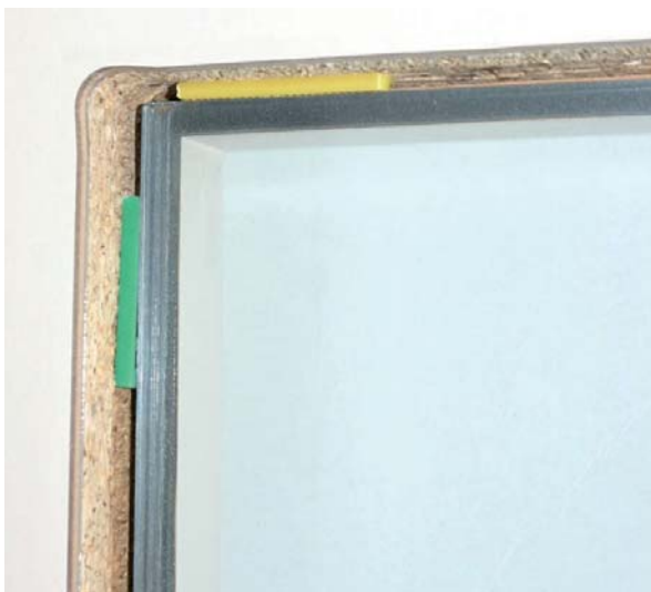
Bild 5 gefräster Radius im Eckbereich und Verklotzung des Lichtausschnittes einer Sperrholztür
