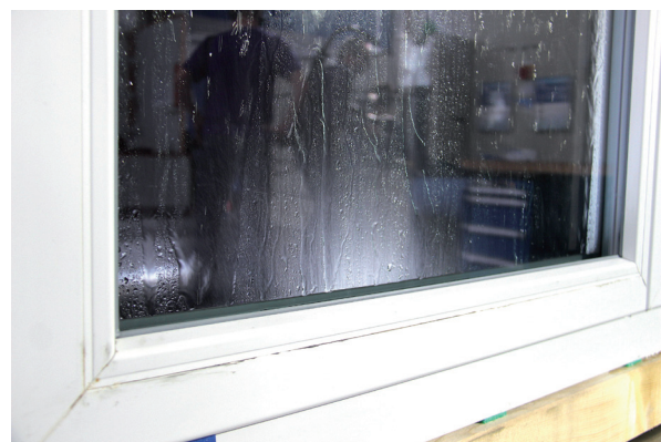
Bild 6 Fensterprüfung auf einem ift-Prüfstand zeigt die Qualität, aber auch undichte Stellen und andere Verarbeitungsmängel
