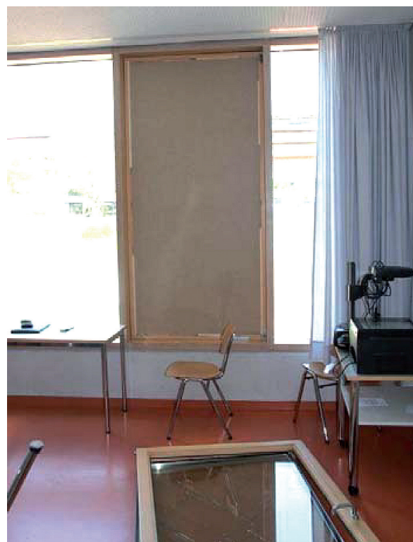
Bild 2 Herausgefallene Fensterflügel aufgrund mangelhafter Fensterbeschläge oder unzureichender Beschlagbefestigung.
