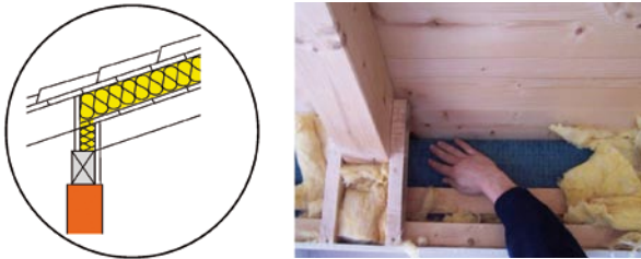
Bild 5: Geöffneter Traufanschluss, mit Feuchteschaden im Neubauzustand
