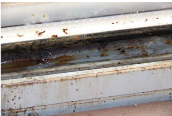
Bild 4 Blick in den mit Dichtstoff ausgefüllten Glasfalz eines Kunststofffensters: kleinere Fehlstellen wie Lunker ermöglichten den Eintritt von Wasser und Schmutz. Nasse Stellen in den Hohlräumen ca. 6 Wochen nach dem Hochwasserereignis
