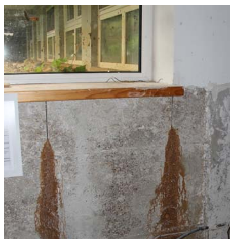
Bild 8 Weitgehend dichtes Souterrainfenster, Eintritt von Wasser und Schmutz im Brüstungsbereich durch undichte Baukörperanschlüsse an den Stoßfugen der raumseitig angebrachten Holzwoleleichtbauplatten
