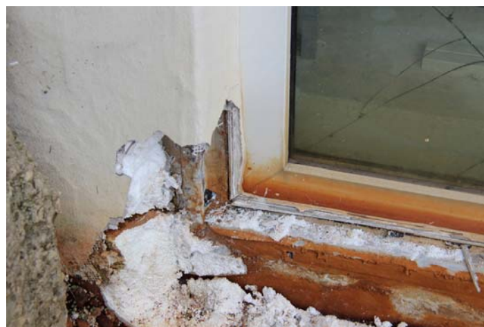
Bild 9 Souterrainfenster, bei dem eine Anstauung von ca. 30 cm Wasserhöhe stattgefunden hat. Während die Fensterkonstruktion in diesem Fall kaum einen Wasserdurchtritt zugelassen hat, ist über den Baukörperanschluss eine erhebliche Menge an Wasser eingedrungen
