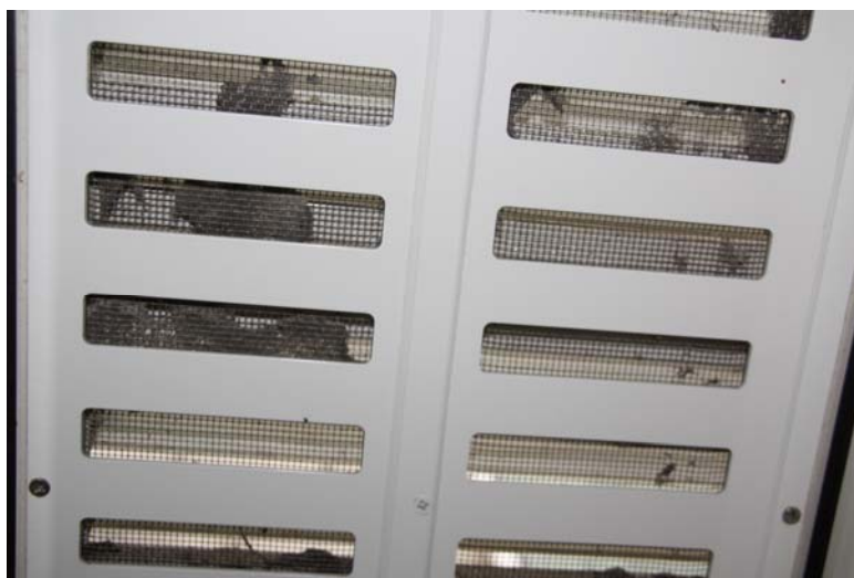
Bild 6 Durch Hochwasser eingetragener Schmutz in einem einfachen Fensterlüftungsgerät
